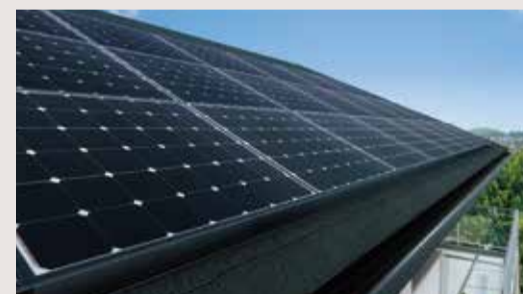
太陽光発電システム
