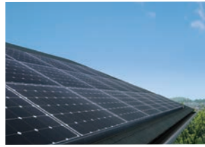
太陽光発電システム
