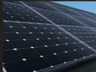
太陽光発電システム
