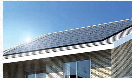
太陽光発電システム
