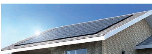
太陽光発電システム
