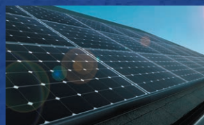
太陽光発電システム
