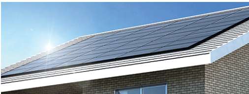
太陽光発電システム
