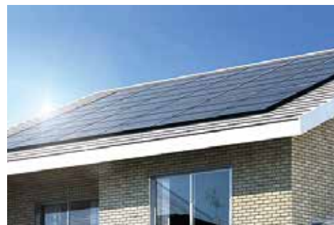
太陽光発電システム
